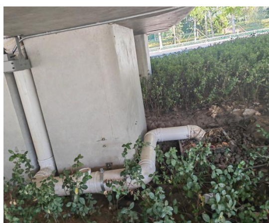
桥面雨水沉淀池
