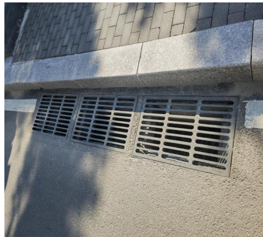
地面路雨水篦子
